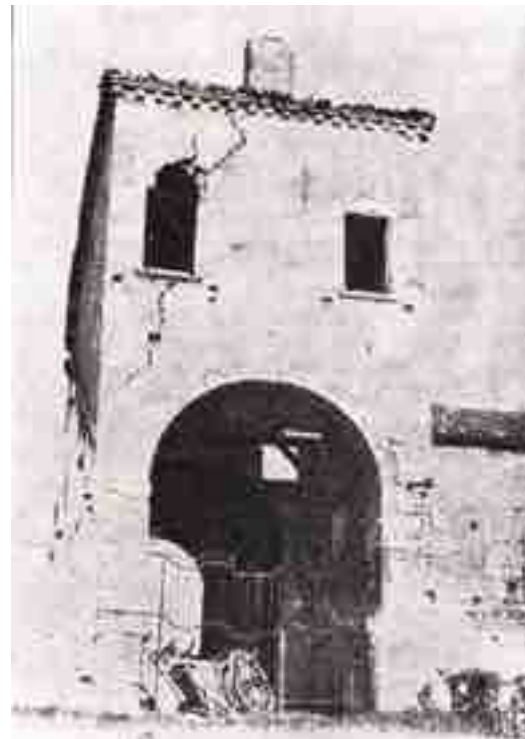
Roversella. Il monumentale voltone costituiva l'ingresso principale alla corte cintata. Le esplosioni provocate il 24 aprile 1945 dai tedeschi in fuga provocarono il crollo dell'antica casa posta a sinistra e le vistose lesioni che si notano nella foto, risalente ai primi anni dell'ultimo dopoguerra. Pochi anni dopo, lo storico manufatto crollò completamente
