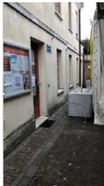
ANCORAGGI E STATO TENDONI PLASTICA ANNERITI DALLE INTEMPERIE
