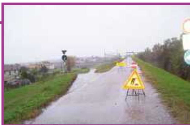
Le transenne che sbarrano l'accesso alla sommità arginale nei pressi della rampa di via Andrea Doria
