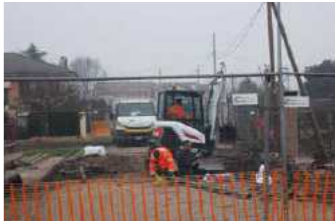
UOMINI E MACCHINE AL LAVORO SUL PONTE DI VIA G.VERDI A MOGLIA
