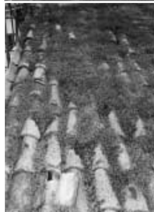
Il tetto ammalorato
