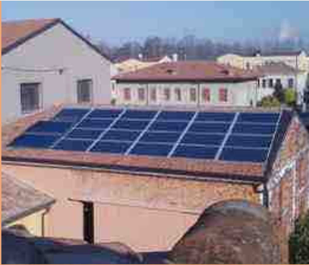
Impianto fotovoltaico installato sul tetto dell'abitazione Martini
